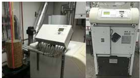
Abb. 25: Kleinf Feuerungsanlage an der HTW Berlin (Fotos: G. Kabengele)
