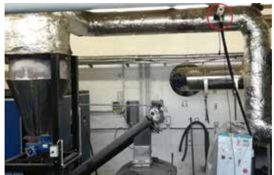
Abb. 21b: Probeentnahmestelle vor Rauchgaskamin (Foto: G. Kabengele)
