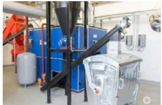
Abb. 17: Anlage im Biomasseheizwerk Malchin (Quelle: Agrotherm GmbH, 2019)
